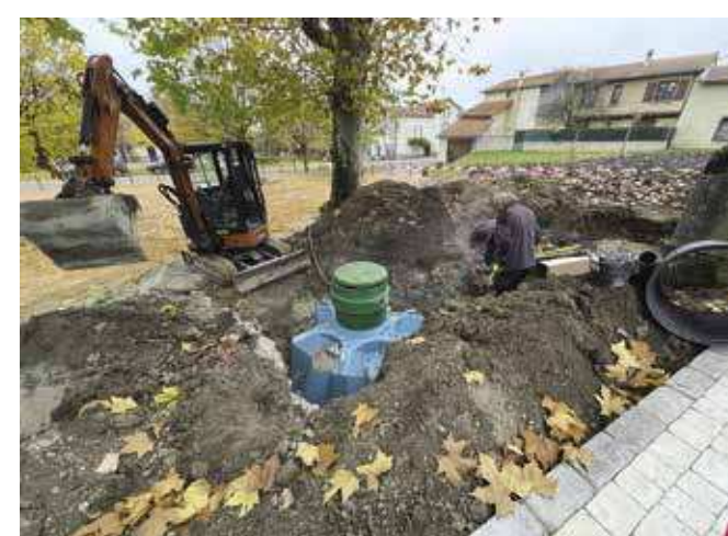
3) Une cuve de rétention d'eau.
